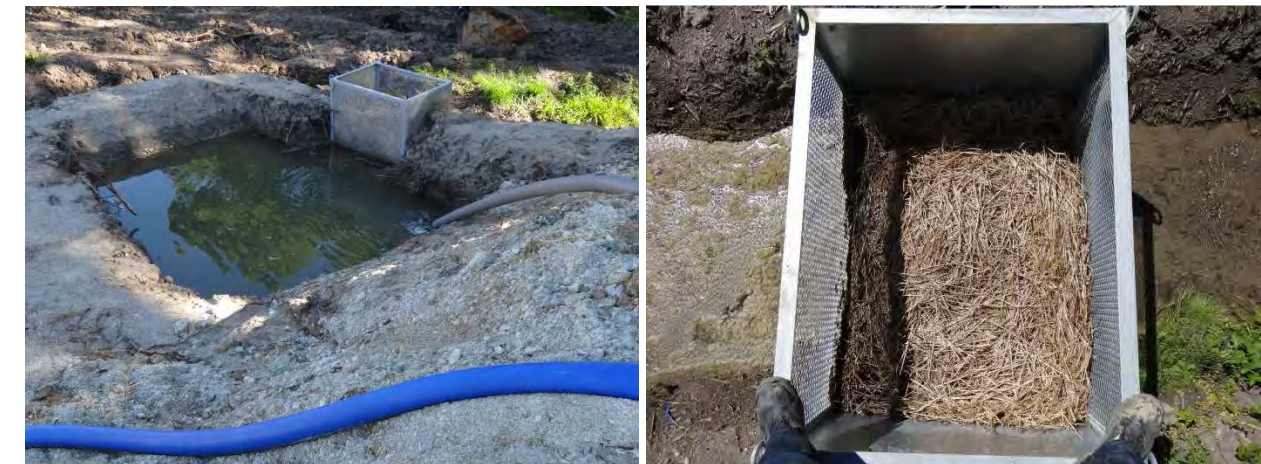
Photographie 17 : Exemples de dispositifs d'assainissement provisoire mis en place en phase travaux (© Egis / D. Ferreira)
