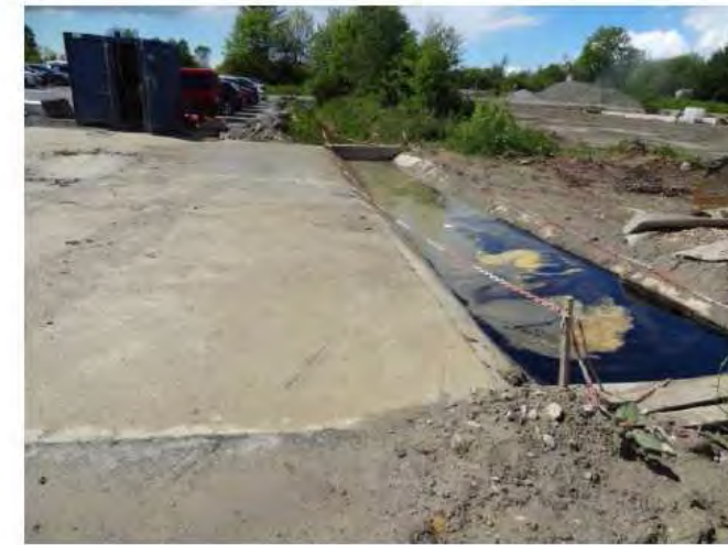
Figure 43 : Exemple de bassin de stockage de produits polluants, d'aire de lavage de goulotte de toupies et d'aire de lavage d'engins équipée en sortie d'un débourbeur-déshuileur (© Egis / D. Ferreira)
