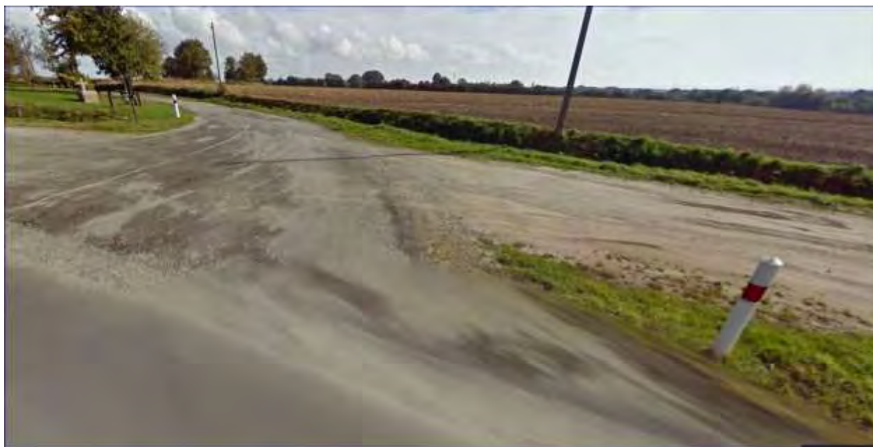
La voie est actuellement sous-dimensionnée.
