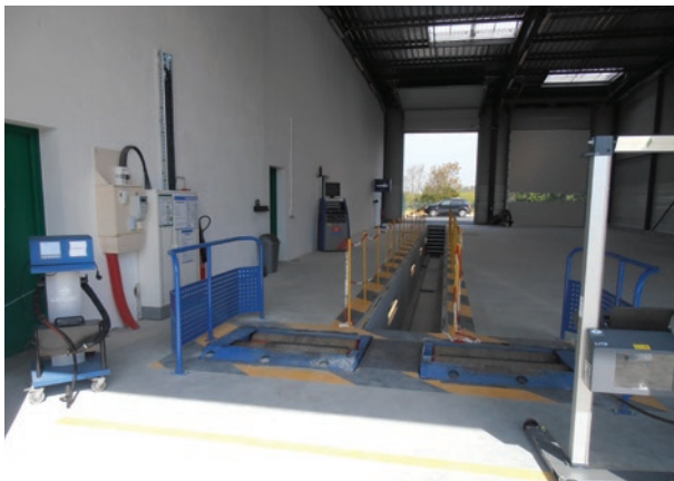
Centre de contrôle
